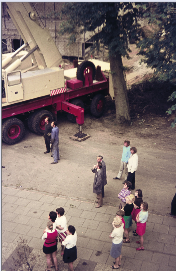
Installation der Verbindungsbrücke zwischen dem „Haus der Ärzte“ und dem neuen Rechenzentrum, 1973
